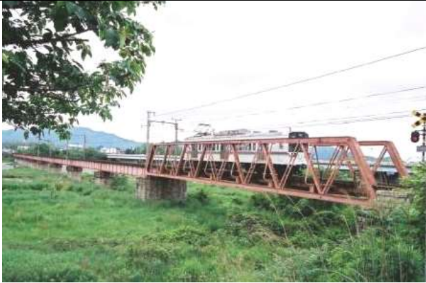
KJK007, 愛知川橋梁, 滋賀県愛荘町,愛知川,近江鉄道本線,1898,鋼橋集覧 T1-003)
