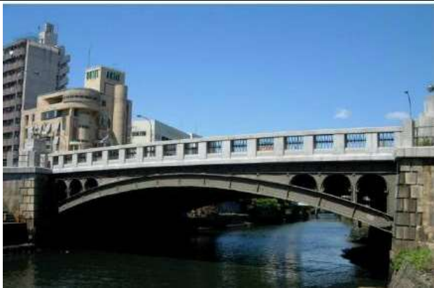
KJK025, 岩井橋, 愛知県名古屋市中区(堀川)市道, 側面に飾り板を有するわが国唯一の橋。側面に飾り板を有するわが国唯一の橋。鋼橋集覧 A4-004
