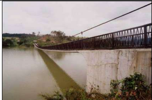
KJK074、アグリカルチャー橋、大分県杵築市山香町(農業文化公園)、1997、吊床版橋、支間 120、幅員 2
