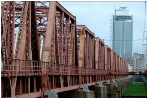
KJK009, 上淀川橋梁, 大阪府大阪市,淀川, JR東海道本線上り線, 1901, 100ftクーパー型トラス(リベット結合)22連を架設、鋼橋集覧 T1-005)
