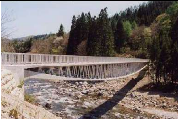
KJK079、ふれあい(交流)橋、岐阜県高山市荘川町中畑(庄川)、2001、吊床版橋、支間 82、幅員 2
