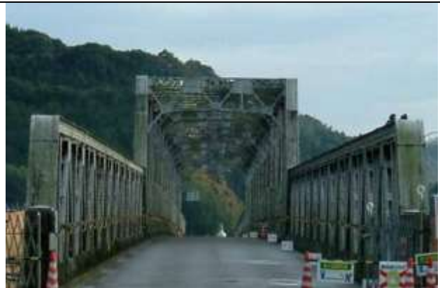
KJK053、旧小丸大橋、宮崎県高鍋市、1948 年に近くの新田原にあった軍用機の格納庫の解体鉄骨を加工・再利用して建設された珍しいトラス橋であった。
