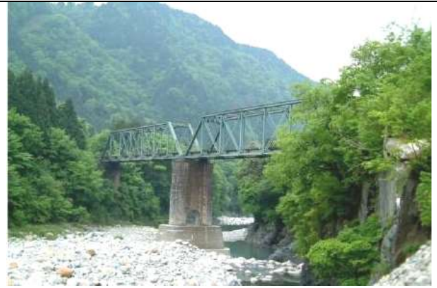
KJK020, 第二渡良瀬川橋梁, 栃木県日光市,渡良瀬川,わたらせ渓谷鉄道,1912,わが国最初の国内製作のクーパー形ピン結合トラス,鋼橋集覧 T1-014
