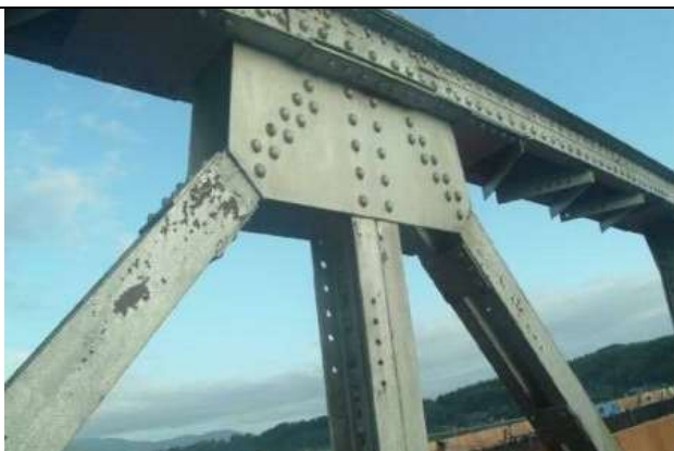
KJK054、旧小丸大橋、前から続く;鉄骨として用いられていた時のボルト孔が多く見られる, 2003 年撤去
