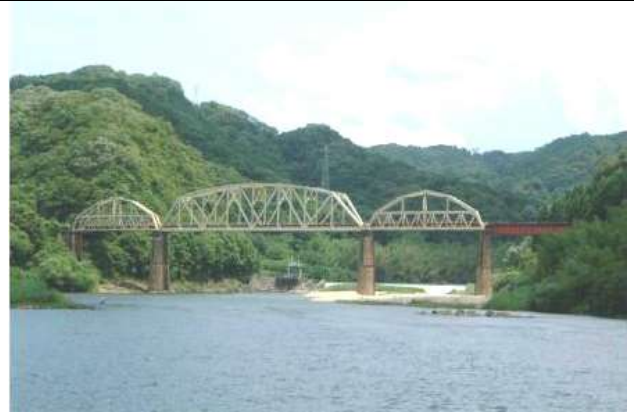
KJK006, 木津川橋梁, 京都府笠置町(木津川)JR関西本線, 1897年に2連の94ftポニートラスと200ft下路プラットトラスを架設。1925年ポニートラス部にアーチ状に上弦材を設けてランガートラスに補強。1926年に下路曲弦ワーレントラスに架け替え。鋼橋集覧 T1-002)
