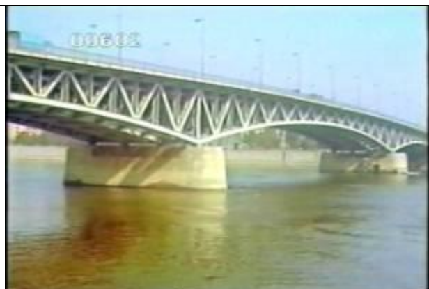
602、KRNT000517、不明橋、HU、ブダペスト、斜めから全景を撮影、3径間連続トラス橋、19860000
