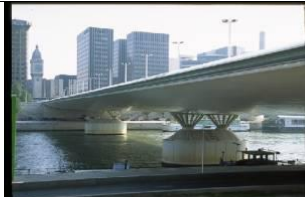
KRS033、シャルルドゴール橋、FR、パリ、鋼ボックスガーダー、1996、207m、セヌ川最後の本格橋
