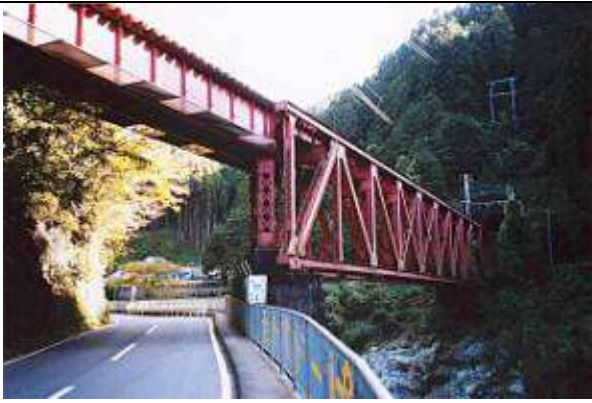
T50642、丹生川橋梁、和歌山県、九度山町、丹生川、南海電気鉄道/高野線、1925
