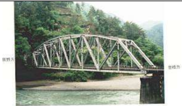
飯田線 平岡～美里 遠山川寄りより 甲府下路曲居アーレントラス T100052、遠山川橋梁、長野県、天竜村、遠山川、飯田線、1951
