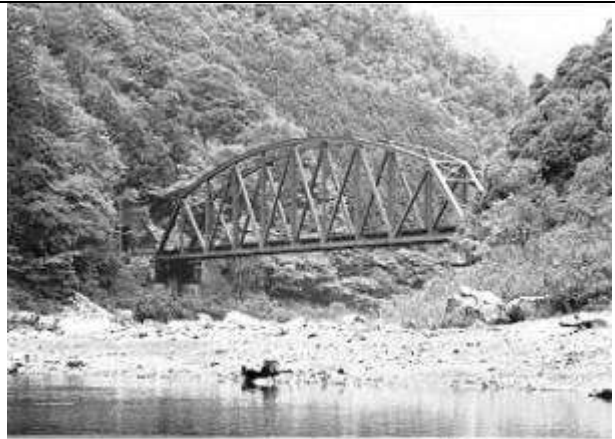
T50161、保津川橋梁、京都府、京都市右京区、保津川、山陰本線(旧線)、1928
