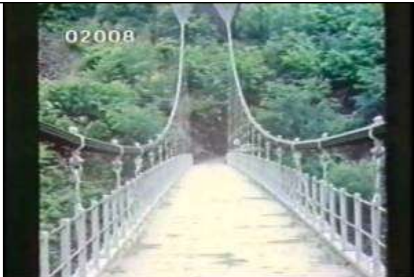
S3010、1955; 2008、KRNSJ00408、白金橋、JP、岩手県、床版、ケーブル、ハンガーと塔、
