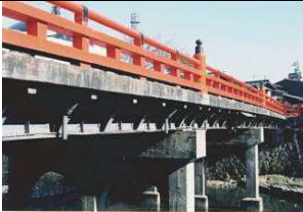
G60231、中橋、岐阜県、高山市、宮川、板桁、 撮影 藤井 郁夫 1995-10-20 作成 1996-2-13 作成 藤井 郁夫
