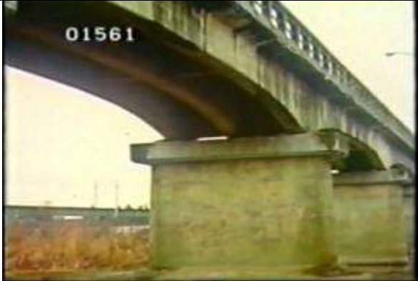
1561、BBS9208114、海老橋、JP、岐阜県、大野町、昭和9年建設、コンクリート桁9、19??????
