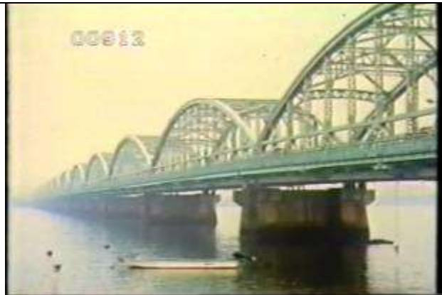
912、BBS9208406、尾張大橋、JP、愛知県、弥富町、昭和8年建設、鋼アーチ橋8、19???????
