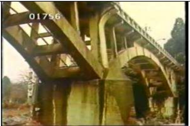
1756、BBS9208316、鹿乗橋、JP、愛知県、瀬戸市、昭和12年建設、コンクリートアーチ橋9、19??????
