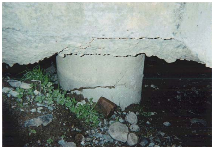
写真-1 杭頭部のひび割れ
