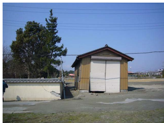
写真8 沈下・傾斜を生じた車庫(2011/3/31撮影)
