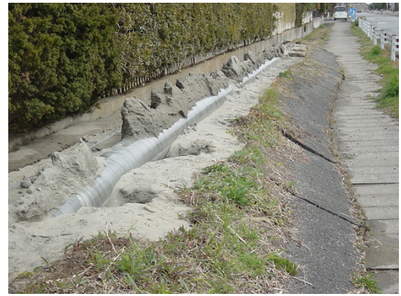
写真14 下水道管の浮き上がり(2011/3/31撮影)
