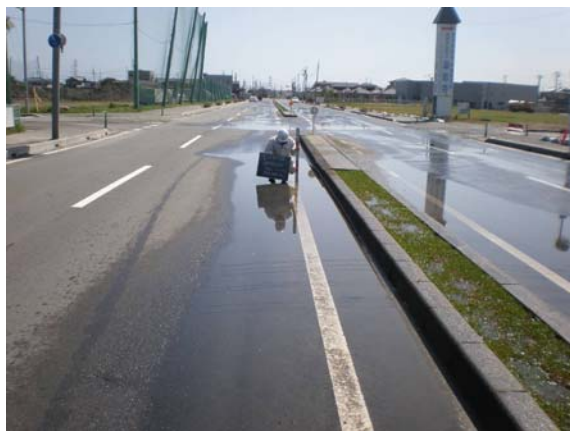
写真18 4車線道路の被災状況
