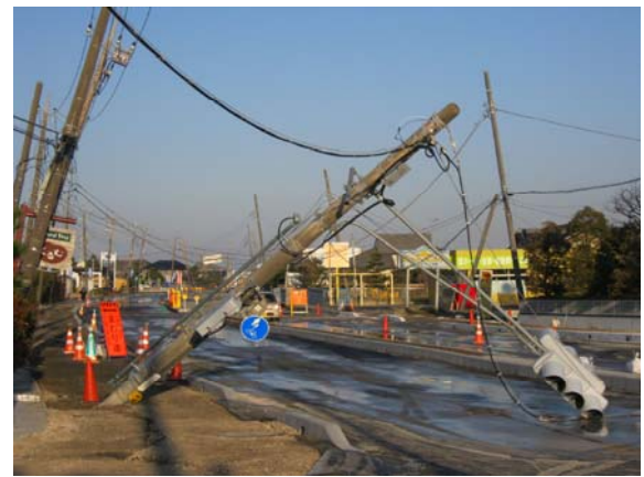
写真15 倒壊した信号柱(2011/3/12撮影)
