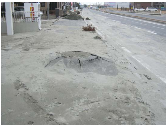
写真12 浮き上がったマンホール
