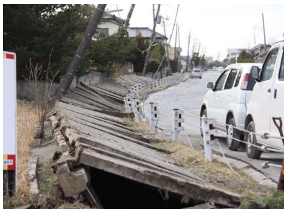
写真13 片側がせり上がった排水路
