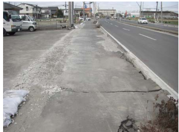
写真21 歩道の被災状況
