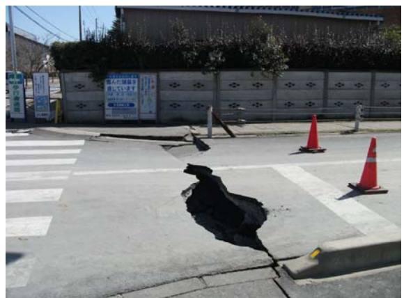
写真23 空洞により陥没した2車線道路の舗装
