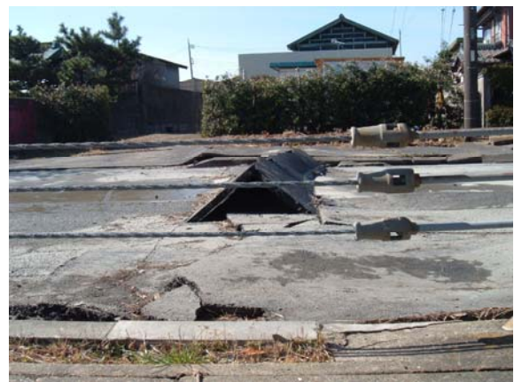
写真22 側方流動で競り上がった2車線道路の舗装版
