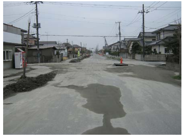
写真20 2車線道路の被災状況
