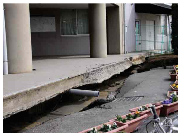
写真10 杭基礎構造物と周辺地盤との沈下差の状況
