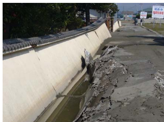
写真9 沈下転倒した土塀(2011/3/31撮影)
