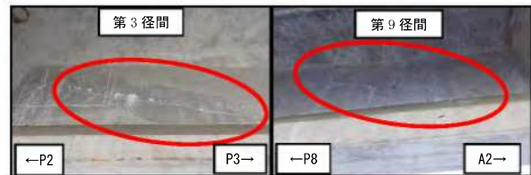
写真-2 PC鋼材に沿ったひび割れ
