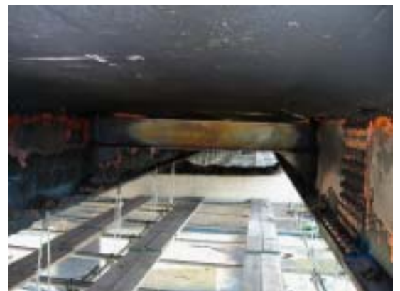
写真-1 被災状況
