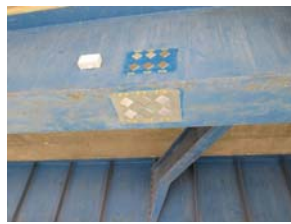
写真-2 設置状況
