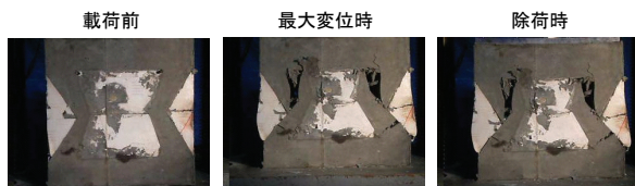
(b) HP-1.5+鉄筋 変形状況
