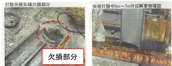
図-13 平成18年災の施工時の矢板打設困難な状況
