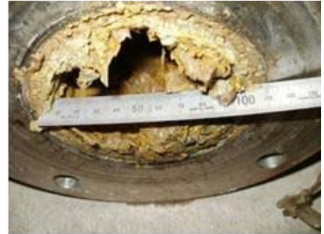
写真-1 ポンプ吸い込み部分の状況
