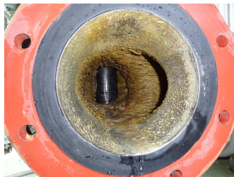
写真-5 濃縮汚泥引抜管の管内付着物
