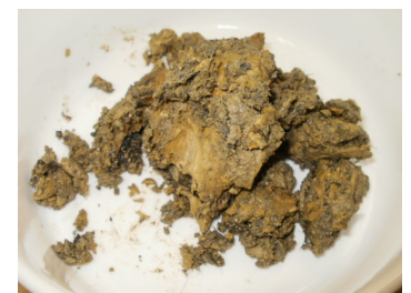
写真-6 配管付着物の状況
