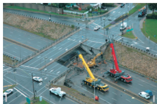
写真-1 崩壊状況 (全景)
