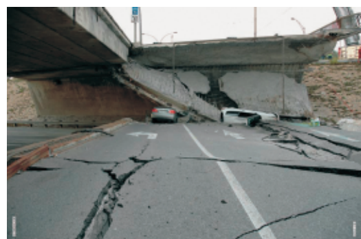
写真-2 崩壊状況 (破壊箇所)
