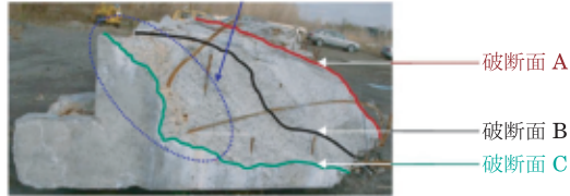
(1) 崩落した桁受部の破断面
