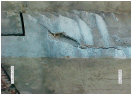
写真-3 崩壊直前の桁受部
